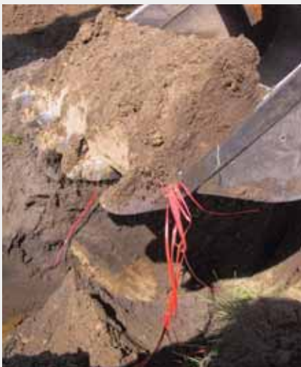
Synlige nettråde ved opgravning
